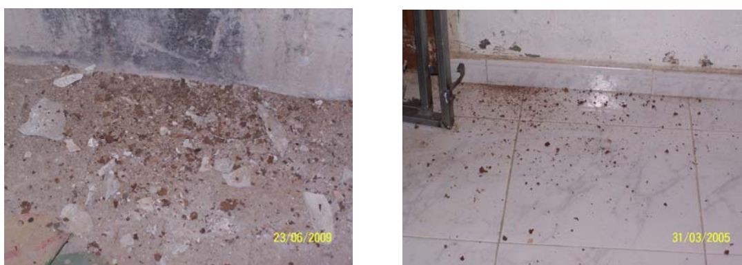
Figura II.11. Imágenes de restos de material en el suelo, que indican que se ha producido ataque de termita subterránea en la estructura de madera
