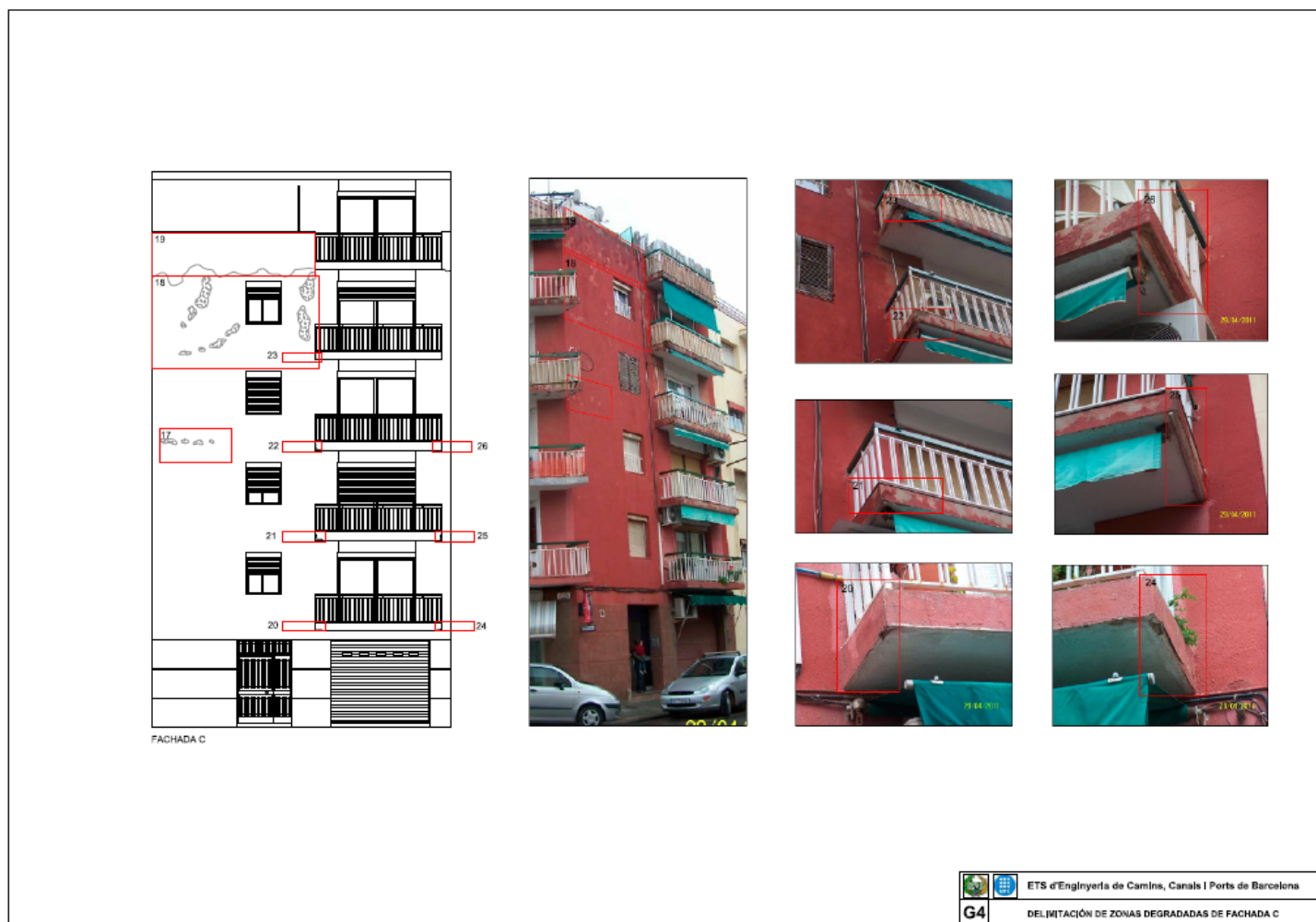
Figura IV.25. Caso real 7. Delimitación de zonas degradadas de la fachada C
