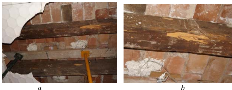
Figura 4.14. Zona de entrevigado que antes de ser apuntalada estaba en situación inestable (a) y ataque de Hylotrupes bajulus (carcoma grande) en viga de madera (b)
