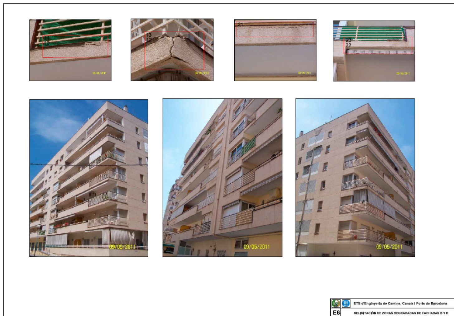
Figura IV.19. Caso real 5. Delimitación de zonas degradadas de las fachadas B y D
