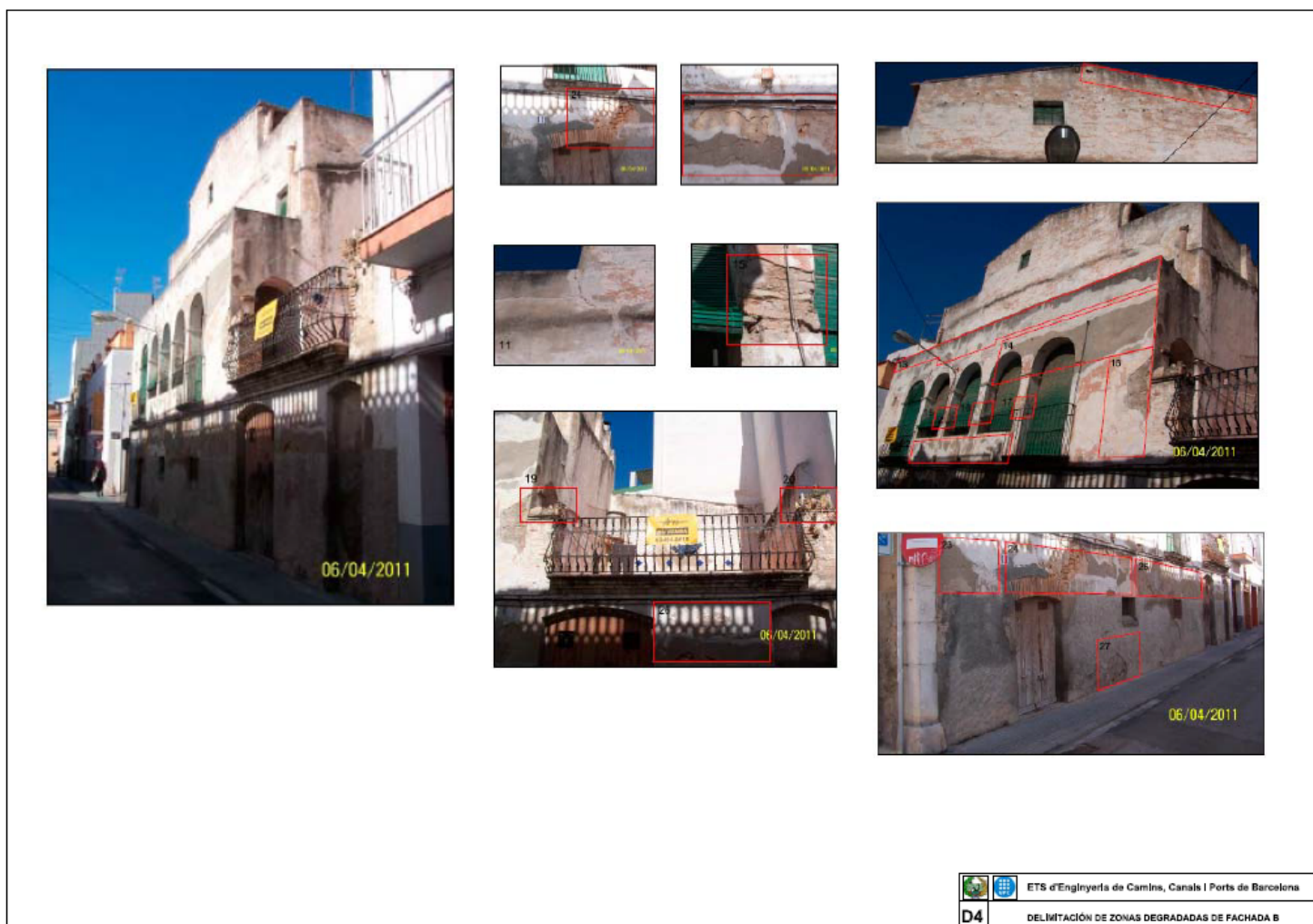
Figura IV.13. Caso real 4. Delimitación (2) de zonas degradadas de la fachada
