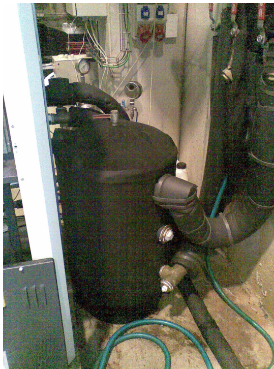
Figura 5-5: Depósito de inercia montado en el circuito de agua fría
