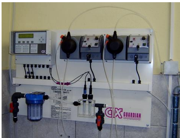
Slika 2. Automatska centrala za nadzor i regulaciju kvalitete vode [2]
