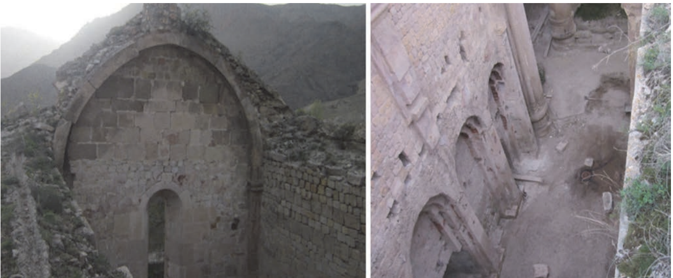
Slika 4. Zapadni krak crkve i potpuno uništeni krov
