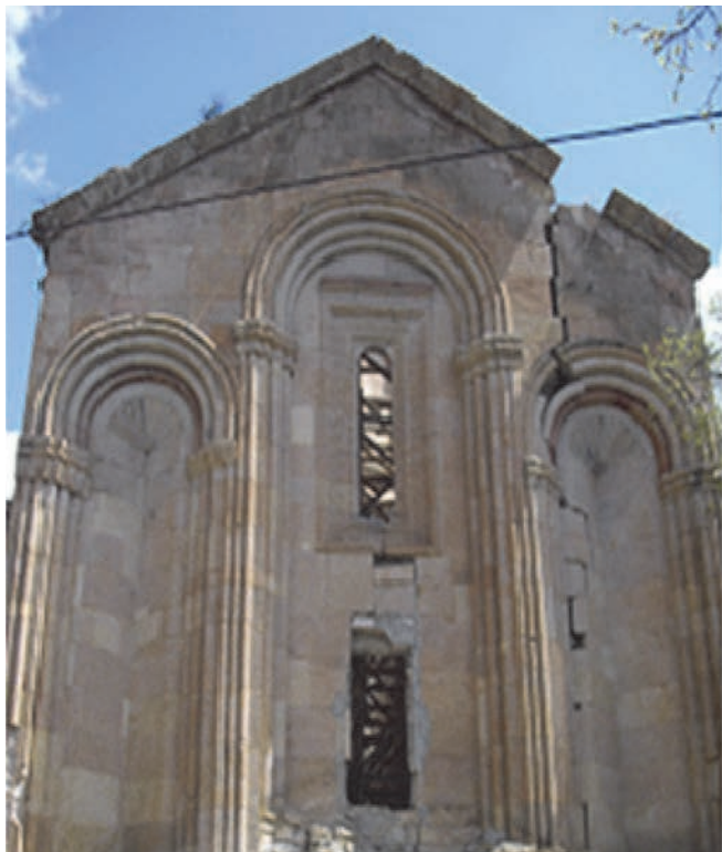
Slika 5. Pogled na odvojeni zapadni i južni zid
