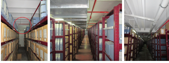
Şekil 9: Gazlı yangın söndürme sisteminin (solda), gider borularının (ortada), havalandırma sisteminin (sağda) arşivler üzerinde tesis edilmemesi.
