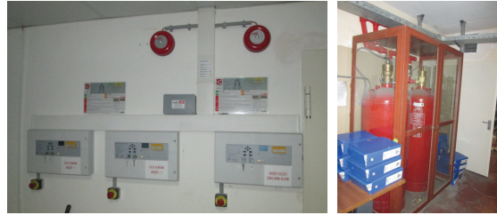
Şekil 8: Gazlı yangın söndürme sistemi panosu, yangın alarm ve butonları (solda), sisteme ait gaz tüplerinin koruma altına alınması (sağda).
