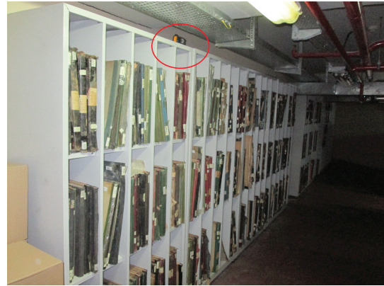
Şekil 12: Topkapı (üstte) ve Merter (altta) Arşiv Binalarında datalogger cihazlarının konulduğu yerler.
