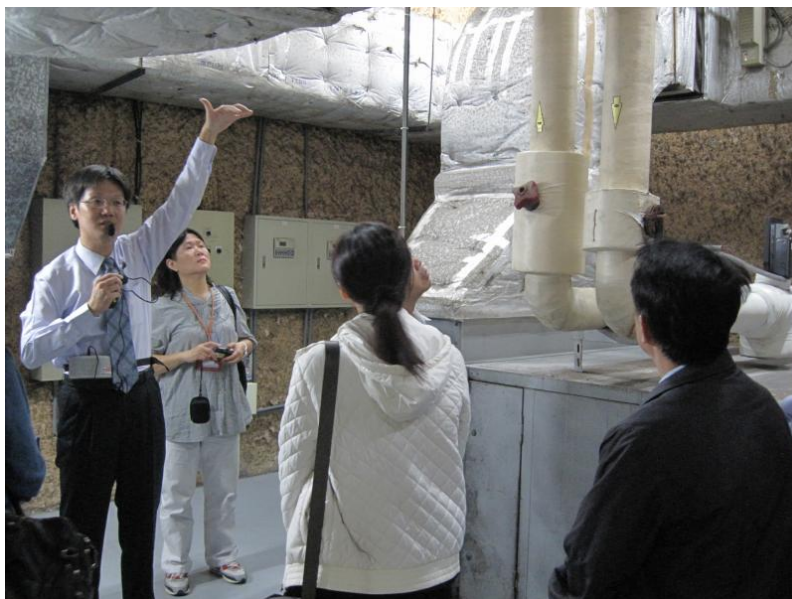
▲中華民國工業安全衛生協會人員帶領參訪人員至本校圖書館 4 樓空調機房參觀並解說本校室內空氣品質之優良作法。
