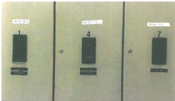
Quadro di distribuzione generale con indicazione delle tre linee CDZ oggetto di monitoraggio ( edificio principale, ala pentagono e CED )
