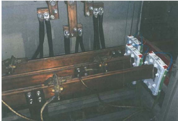
Installazione dei TA del misuratore principale sulle sbarre di arrivo trasformatori
