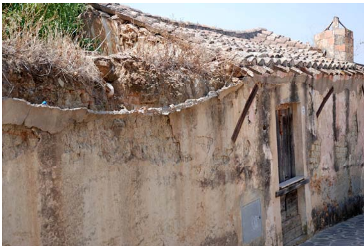
Fig. 29. Abitazione di Santadi in stato di crollo.
