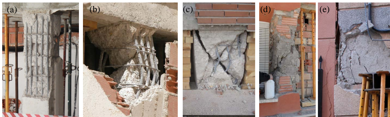
Figura 6. Roturas frágiles (DS4): pilar a cortante por falta de jerarquía (a); pilar a cortante por interacción con la tabiquería (b); pilar corto (c); pilar “cautivo” (d); y nudo a cortante (e).
