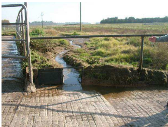
Figura 68. Compuerta para salida de efluentes sobre el terreno hacia las cavas (Sitio N° 4)
