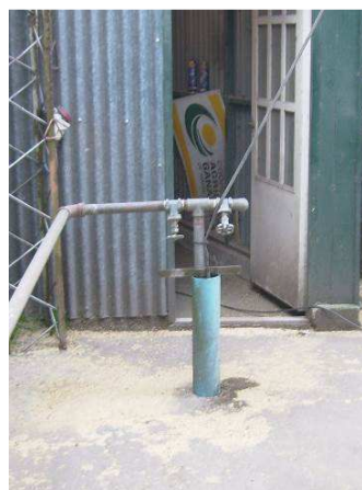
Figura 54. Pozo N° 11. Gardey.
