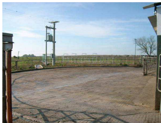
Figura 67. Corrales de encierre luego del lavado con manguera a presión (Sitio N° 4)
