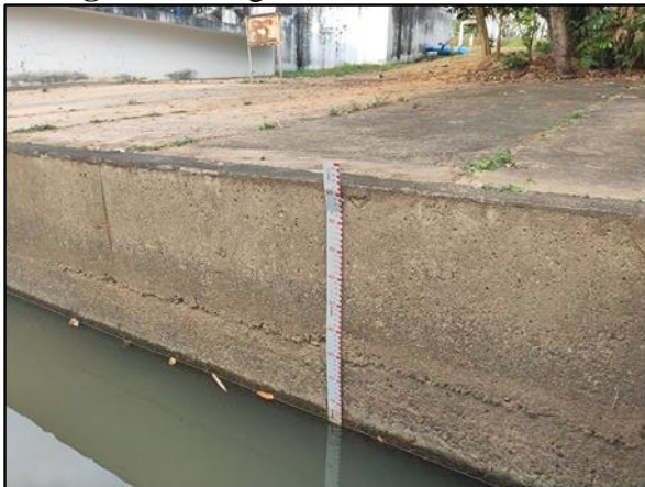
Figura 4 - Régua linimétrica instalada
