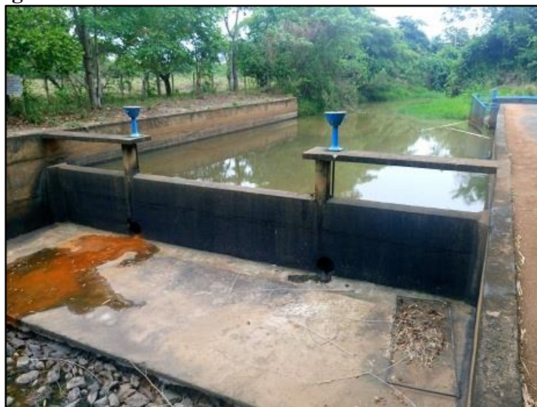
Figura 7 - Vertedor sem vazão remanescente em 23/10/2017.
