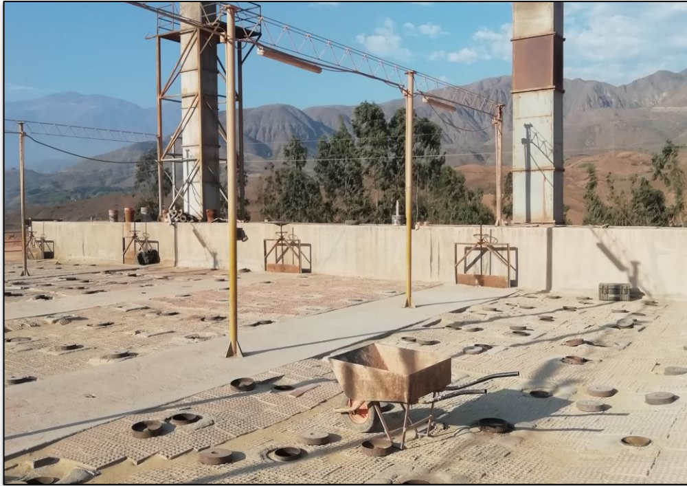
Figura 45: Techo de horno industrial.
