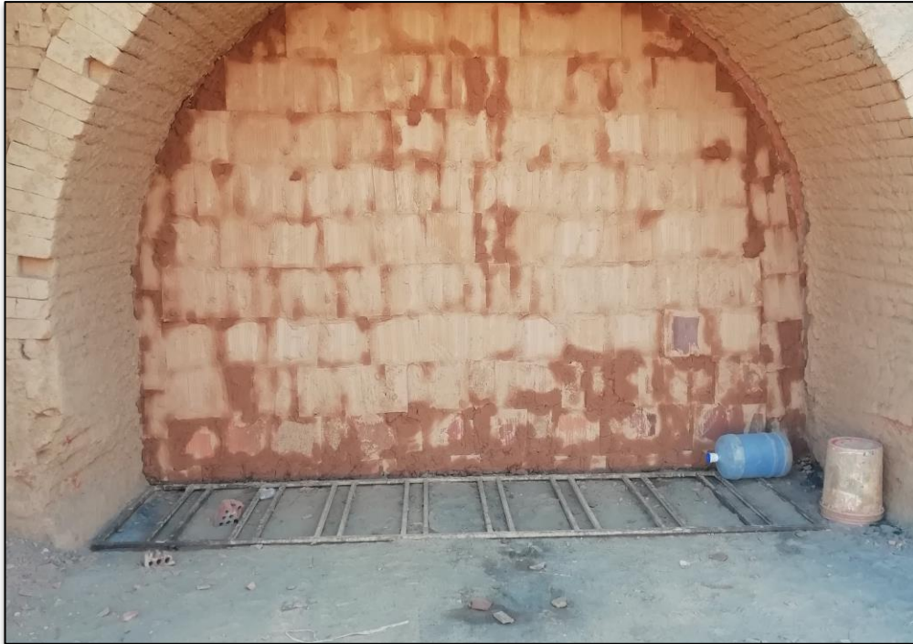
Figura 43: Vista de ingreso a horno, una vez cerrada.
