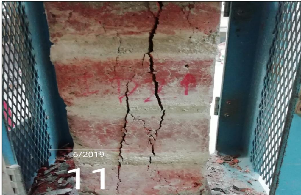
Figura 81: Tipo de falla de la pila.
