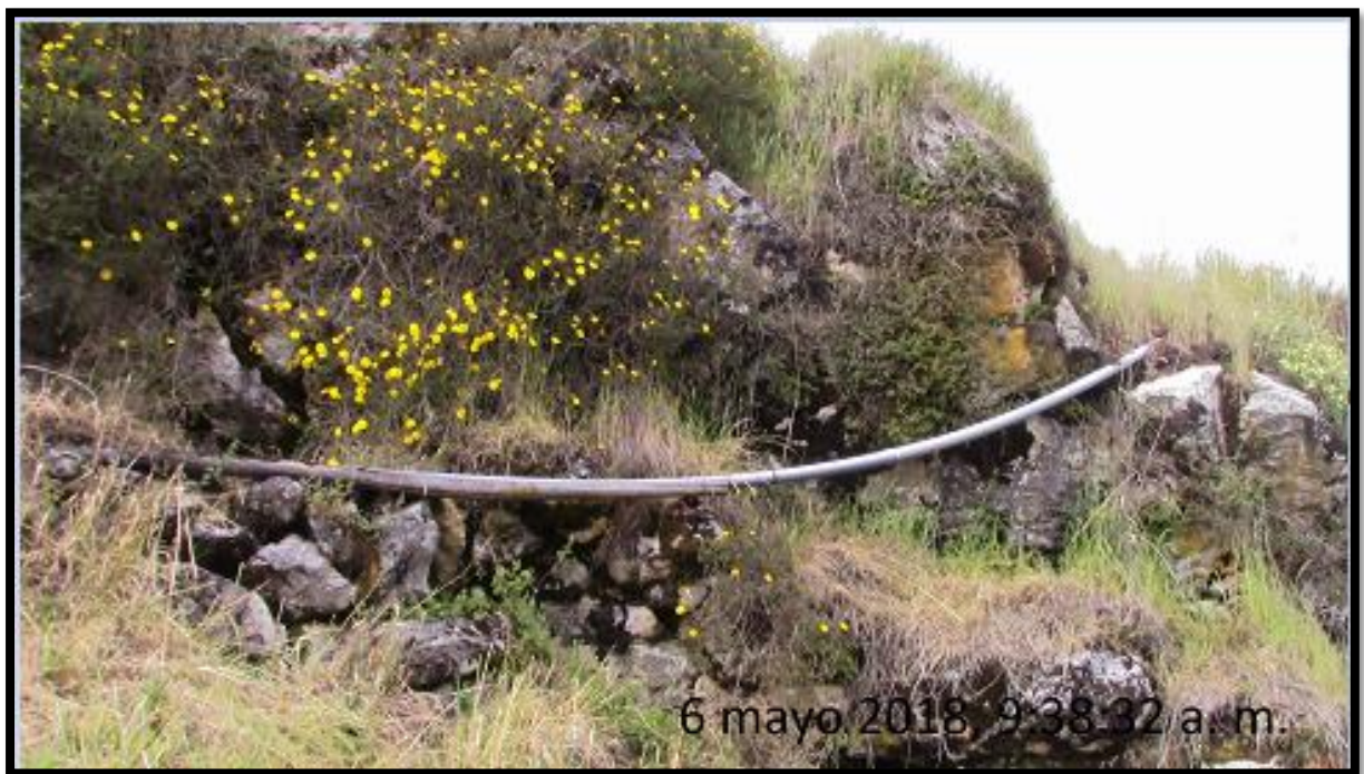
Pase aéreo de línea de conducción del sistema Morcilla Alto
