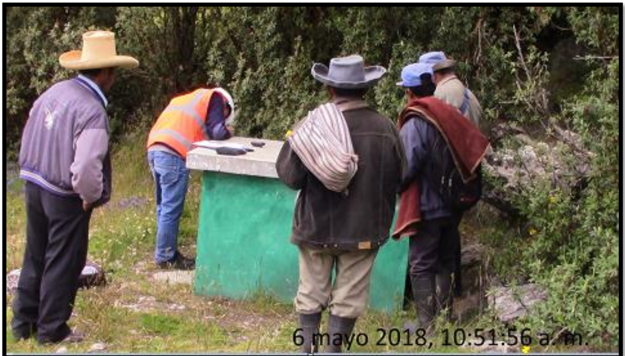
Verificación de cámaras rompe presión tipo 7 del sistema de agua potable, Morcilla Alta.
