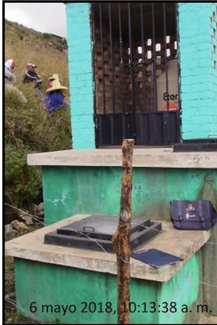
Caseta de cloración sobre el reservorio del sistema de agua potable Morcilla Alta
