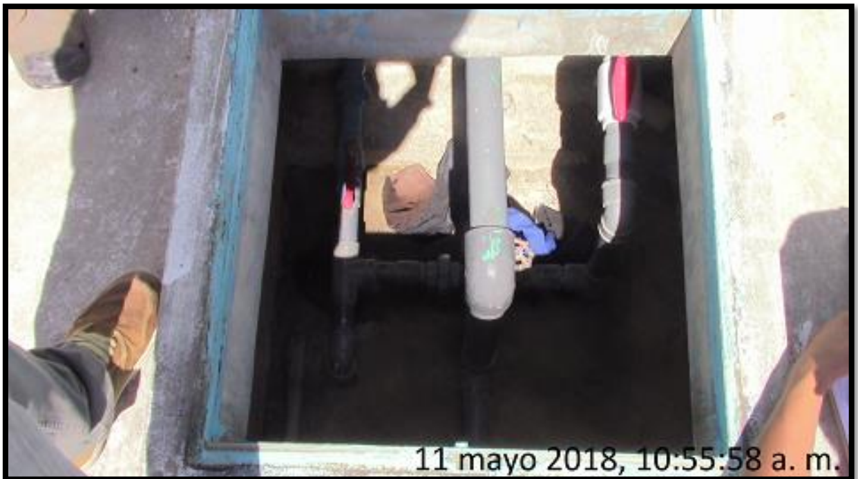
Caja de válvulas del reservorio 1
