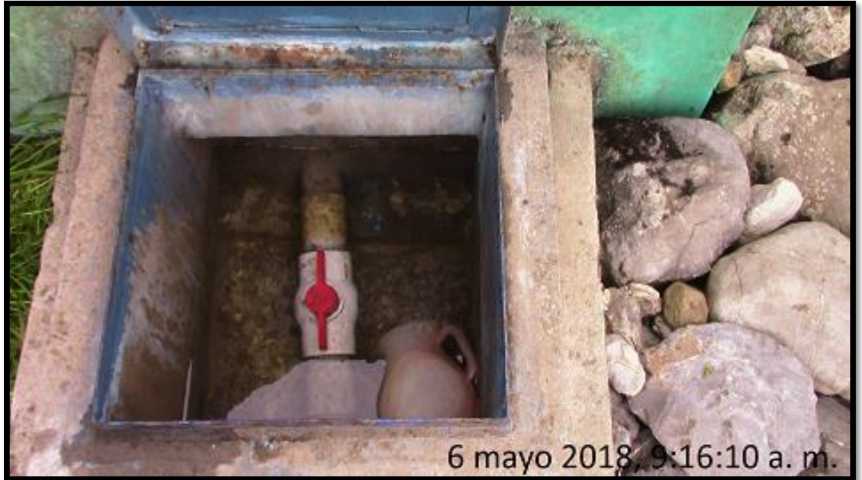
Cámara de válvulas de la captación la colpa: Morcilla Alto.
