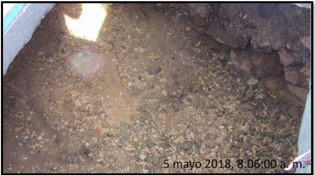
Interior de la captación romero la calzada la tranca se observa que no cuenta con canastilla
