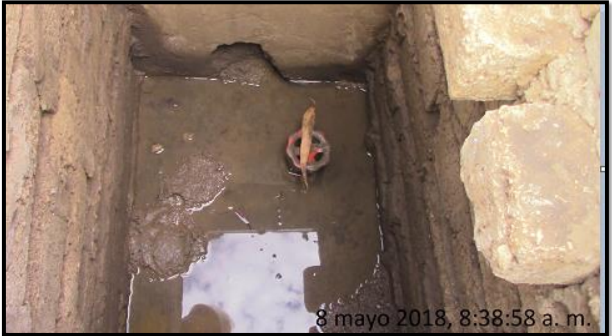
Válvula de la captación se observa que se encuentra en mal estado
