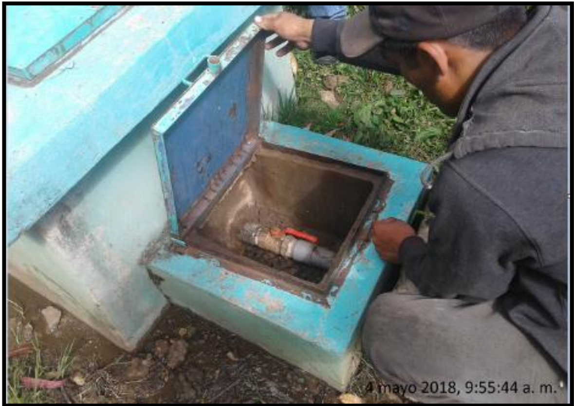
Caja de válvulas de la captación challuas Huayanmarca
