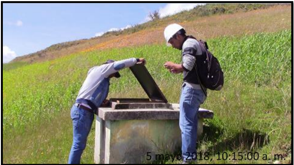
Verificación de las cámaras rompe presión tipo 7
