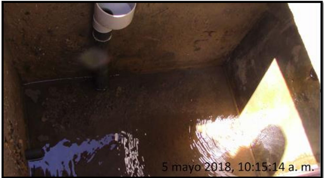
Interior de las cámaras rompe presión tipo 7
