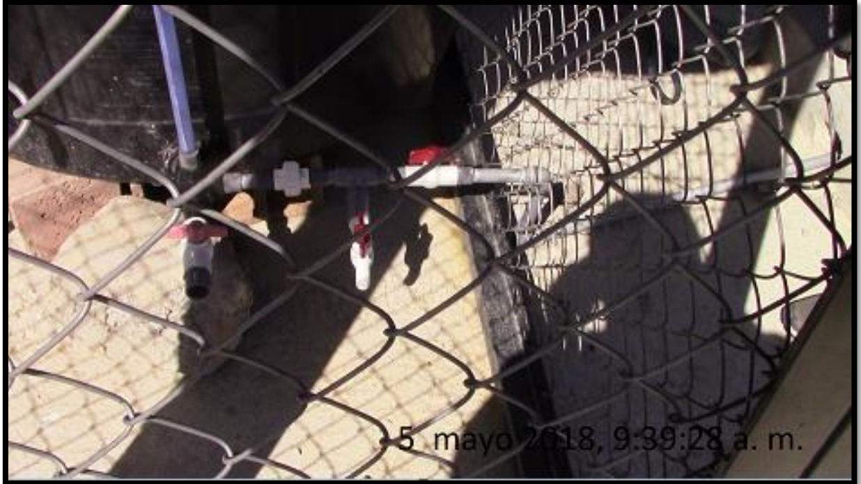
Sistema de cloración del sistema de agua potable la tranca 1.
