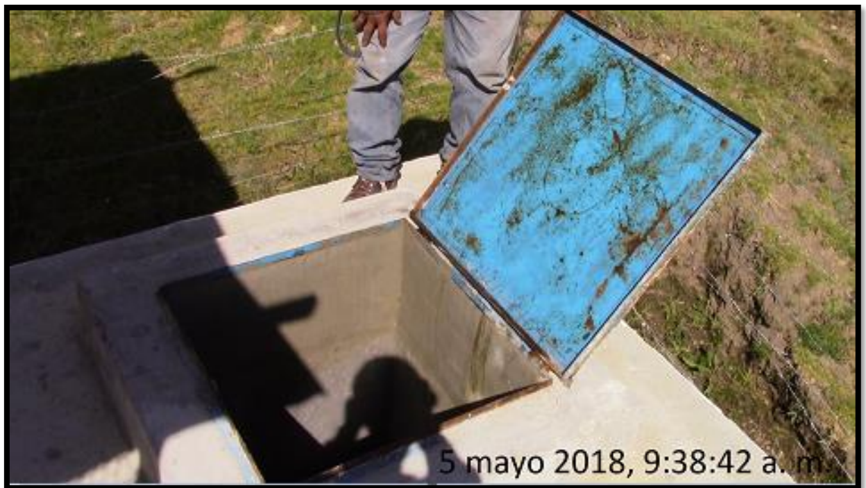
Tapa del reservorio del sistema de agua potable La Tranca 1
