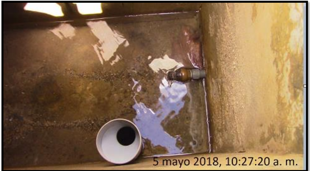
Interior de las cámaras rompe presión tipo 7
