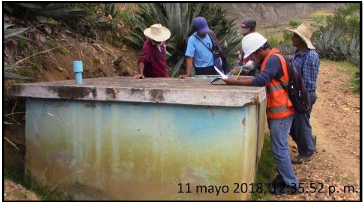
Verificación de las cámaras rompe presión tipo 7
