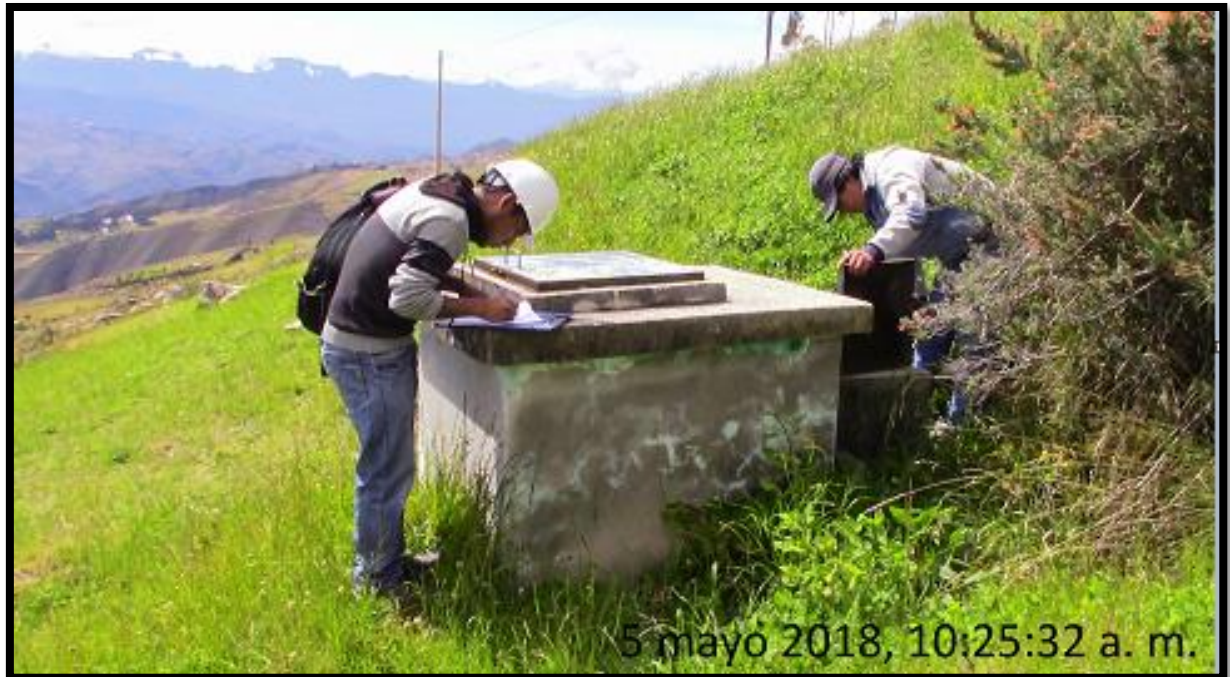
Verificación de las cámaras rompe presión tipo 7
