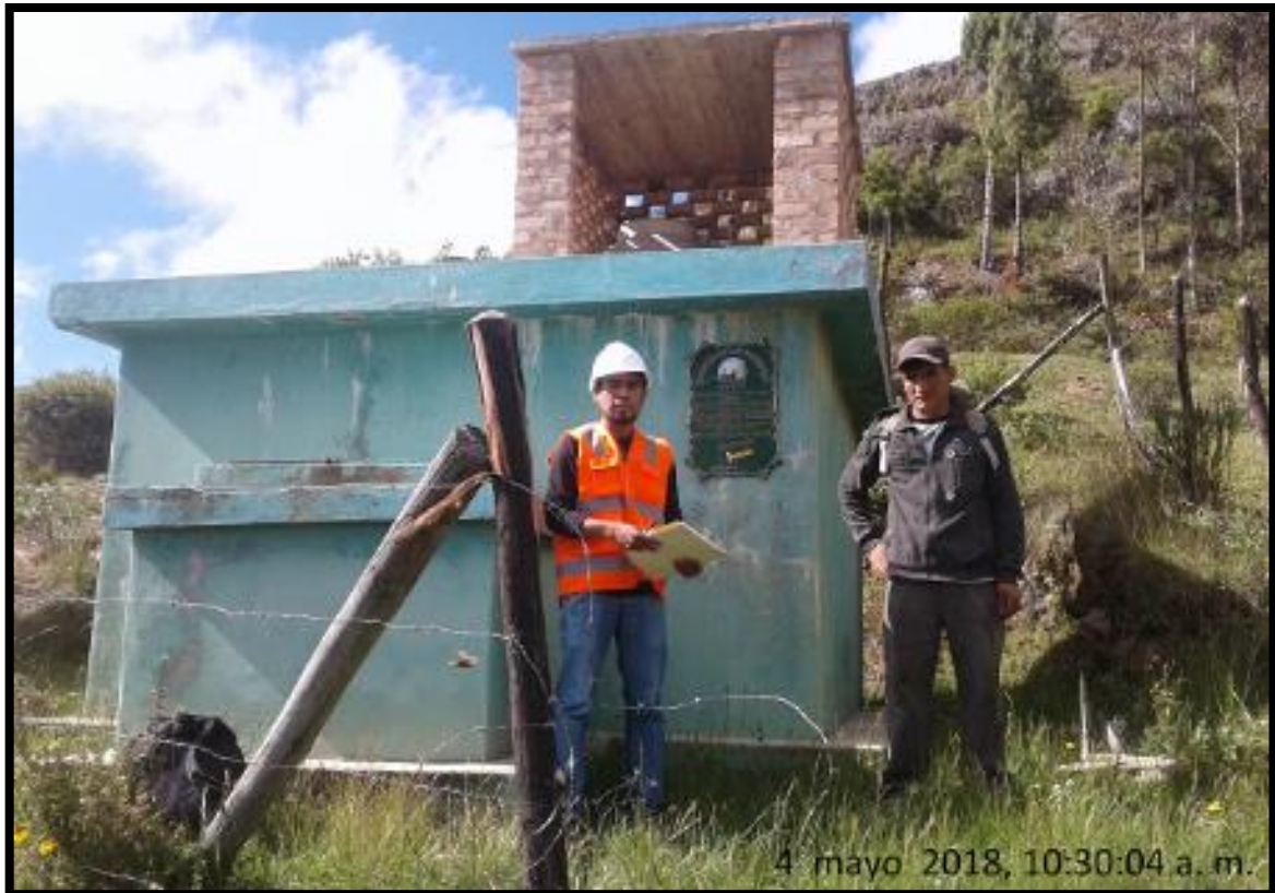
Reservorio del sistema de agua potable Huayanmarca la cual se observa el cerco del reservorio en mal estado
