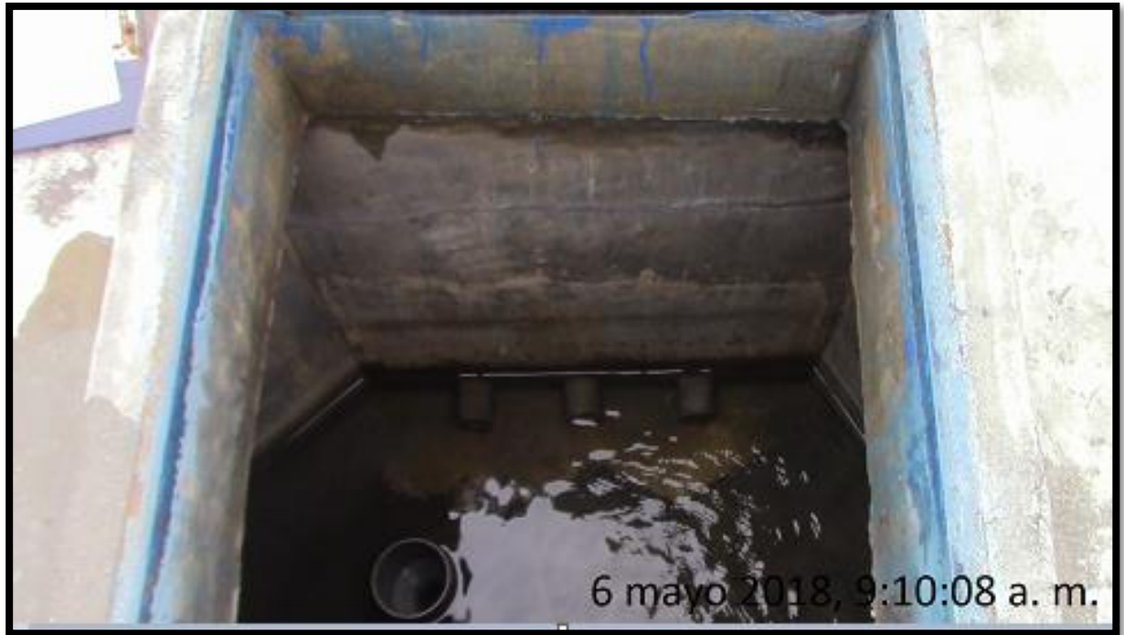
Cámara colectora de la captación la colpa: Morcilla Alto
