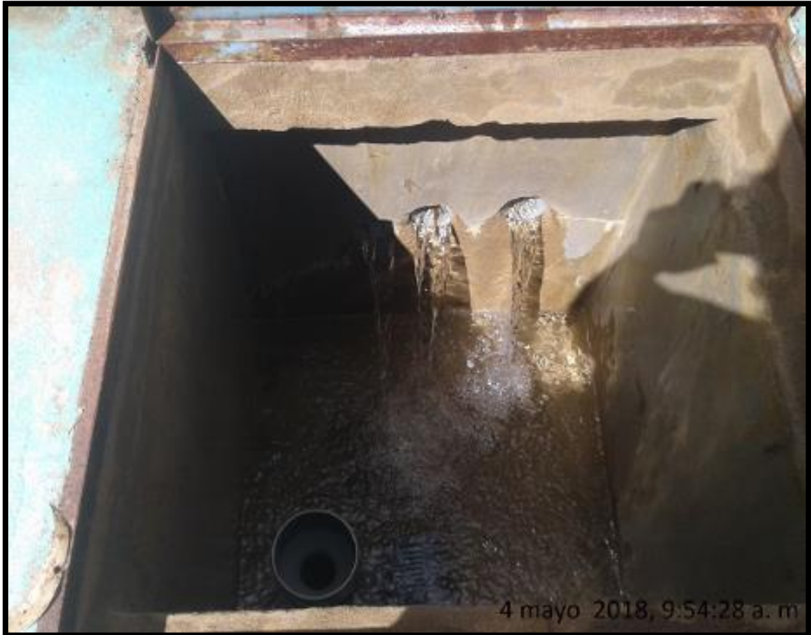
Cámara de reunión de la captación Challuas
