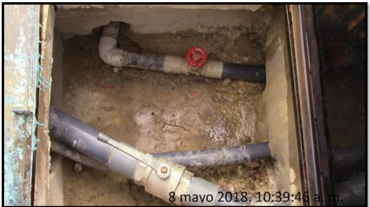
Caja de válvulas del reservorio se observa que no cuenta con las válvulas necesarias
