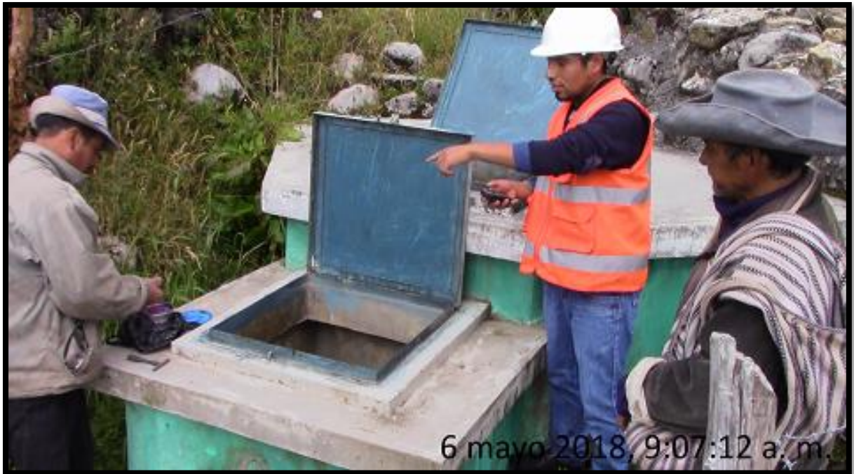
Verificación de la captación la colpa morcilla alta.
