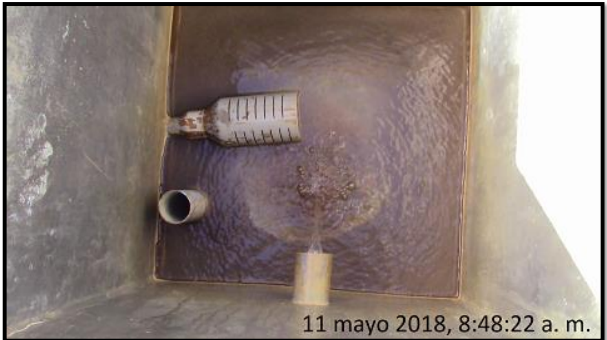
Cámara colectora de la captación 1 Cebadin
