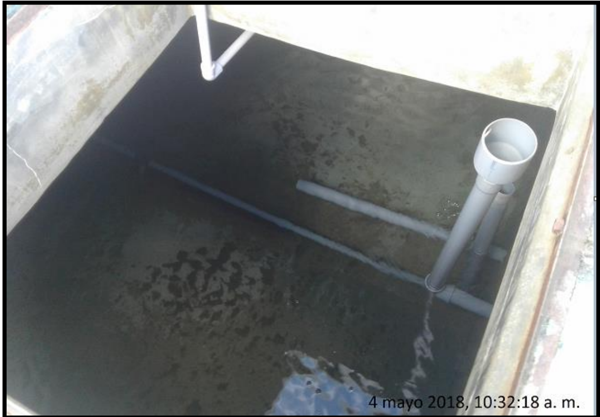
Tanque de almacenamiento del reservorio del sistema de agua potable de Huayanmarca
