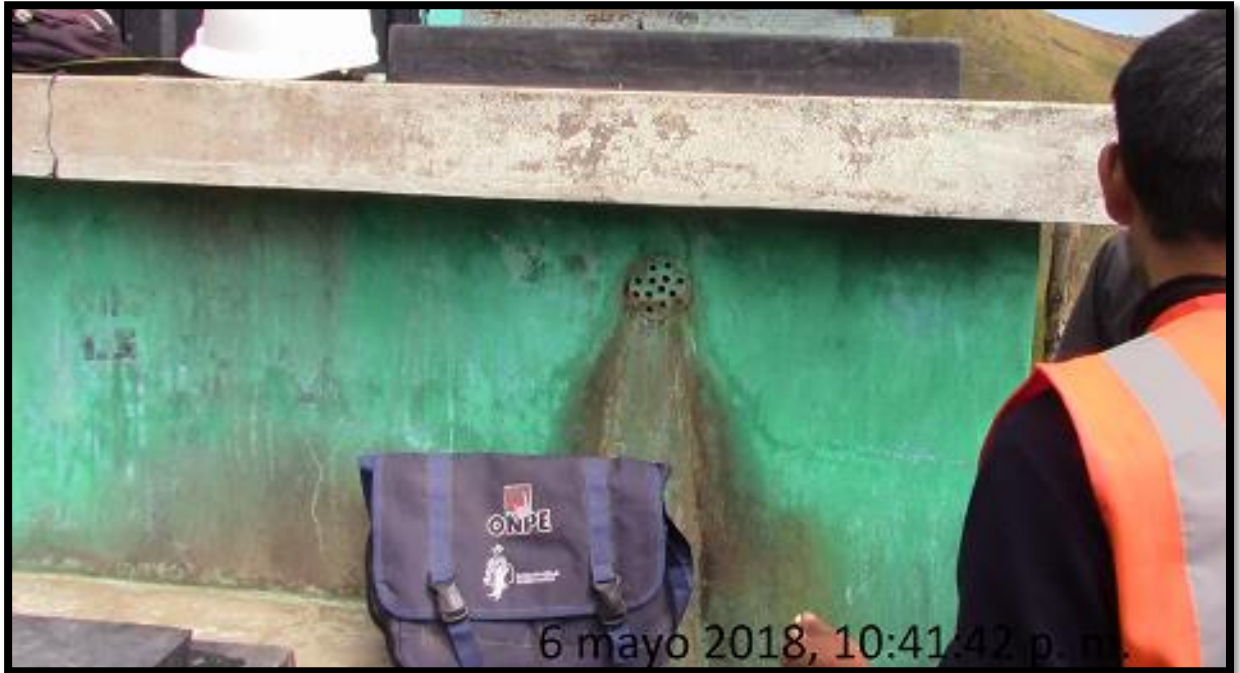
Ventilación del reservorio del sistema de agua potable morcilla alta
