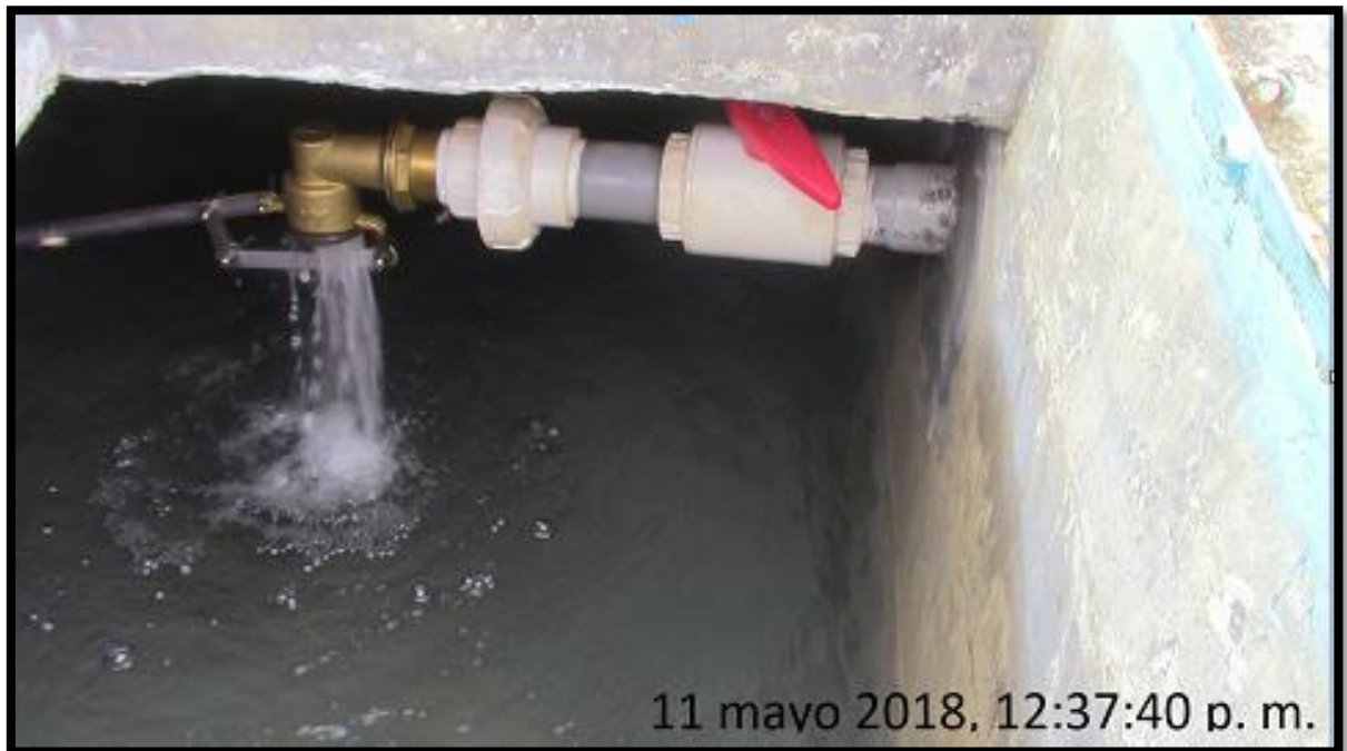
Interior de las cámaras rompe presión tipo 7
