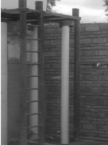
Figura 4: Vista del vertedero y Filtro rápido.
