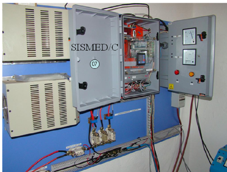
Figura 2– Montaje del SISMED/C en el tablero de Glencros, 24/5/2010
