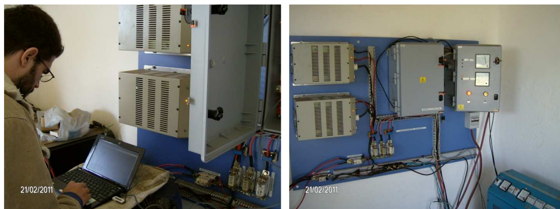
Figura 3 – Actualización del Firmware SISMED/C y vista del tablero operando 21-2-2011
