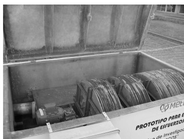
Figura 1: Planta compacta de tratamiento de líquidos residuales en la UCC
