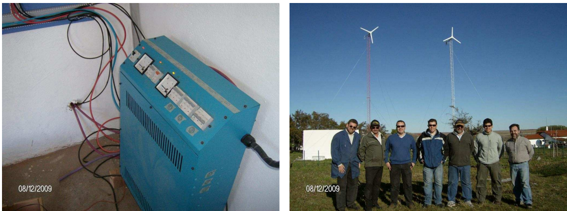
Figura 5 (izq) – Prueba inicial regulador-inversor y (der) integrantes del equipo de instalación con molinos funcionando
