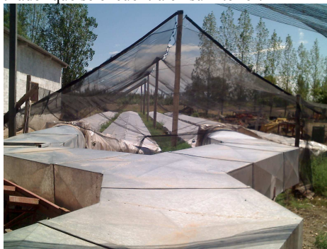
Figura 1: Vista frontal de Colectores solares y Pantalón realizado en Chapa galvanizada, y con la protección antigranizo de los colectores
