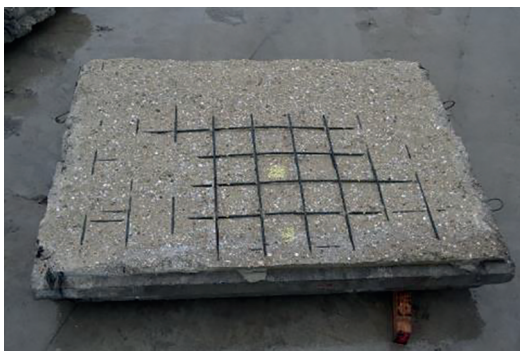
4. ábra. A falpanelelemek károsodása a tűz után
