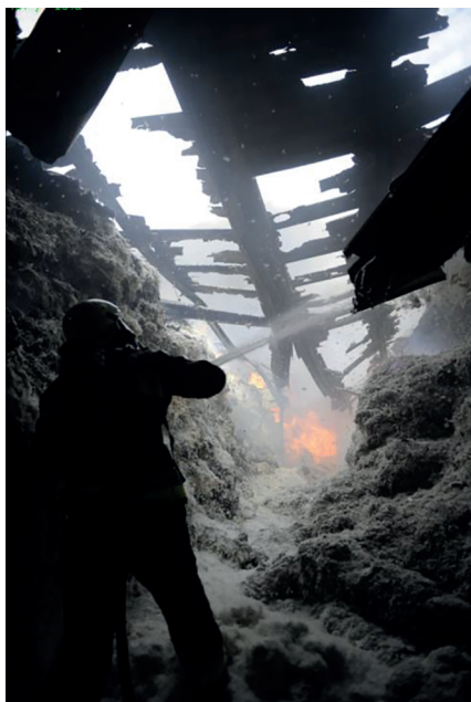
6. ábra. Tűzoltó-beavatkozás és leszakadt tartószerkezet
