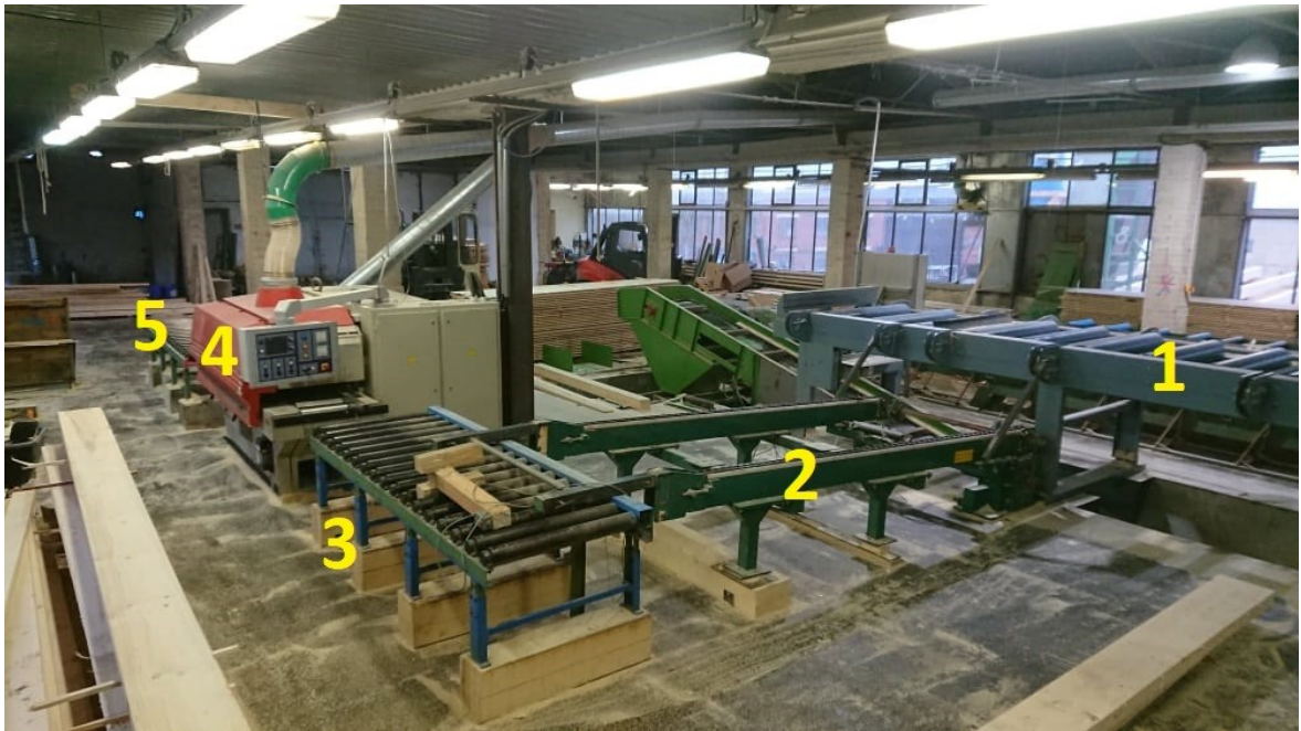
Obrázek 11 - Aktuální stav dopravníků, 1-Dopravník Primultini, 2- Dopravník příčný pro dopravení polotovaru před rozmítací pilou, 3-Válečkový dopravník před rozmítací pilou, 4-Rozmítací pila, 5-Válečkový dopravník za rozmítací pilou
