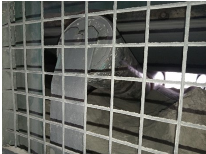
Obr. 45 Obtížně přístupné válečky pásového dopravníku [autor]
