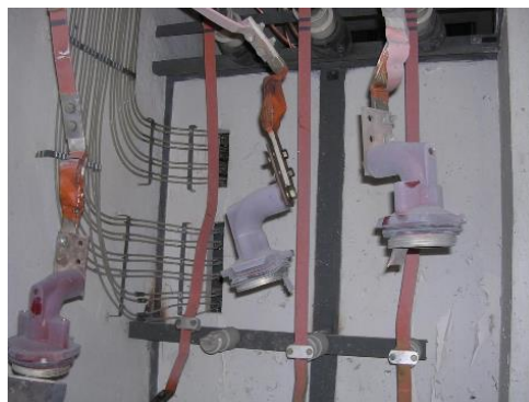
Obr. 7 Utržení podpěrky a zkroucení hliníkový propojek v důsledku nadměrného dynamického namáhání. [5]
