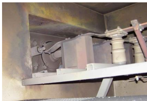
Obr. 8 Upálení přívodu v důsledku tepelného přetížení průchodem zkratového proudu. [5]
