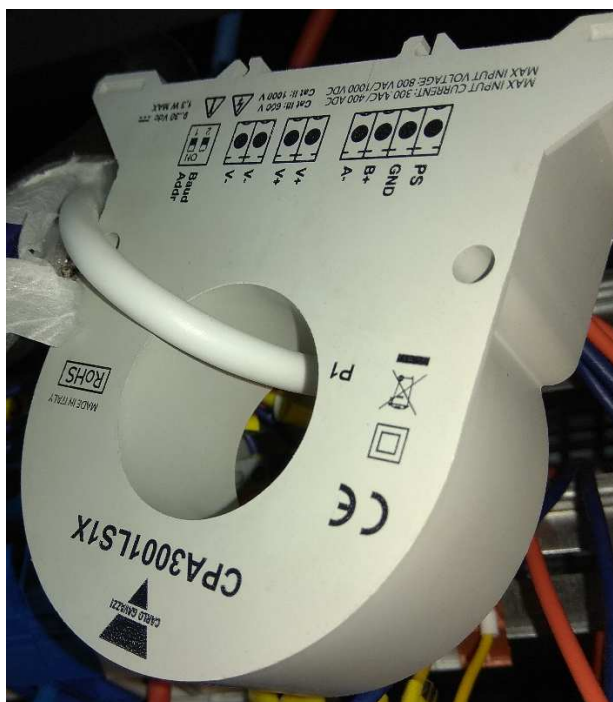
Obr. 3-17 Elektroměr s digitální komunikací pomocí protokolu Modbus RTU
