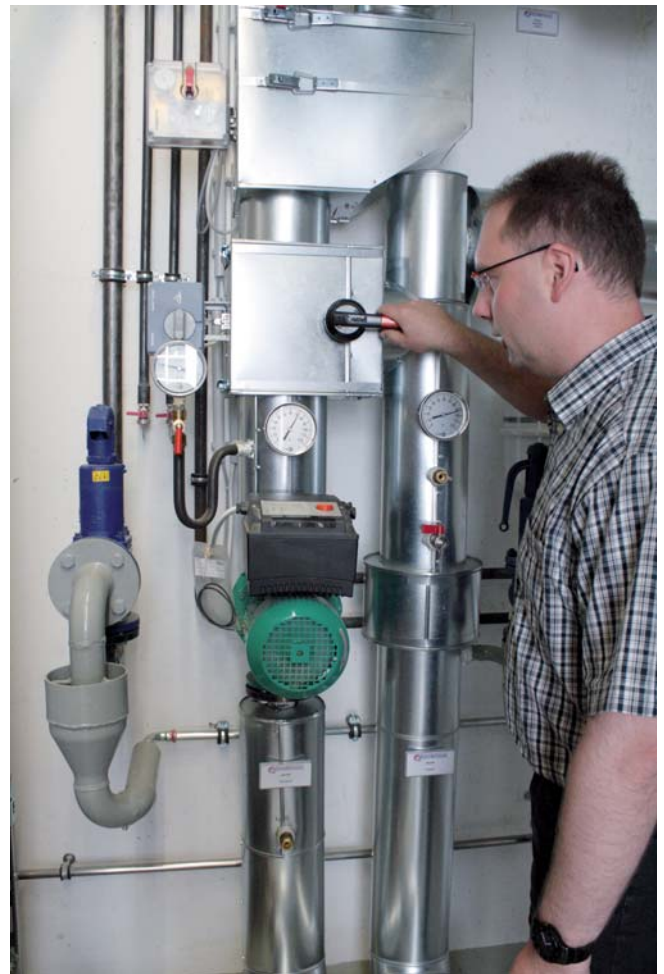
▲ Die hauseigene KWKK-Anlage (Kraft-Wärme-Kälte-Kopplung) des EFZN
