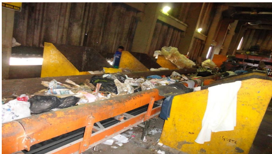
Figura 1. Área interna de esteiras da Usina.
