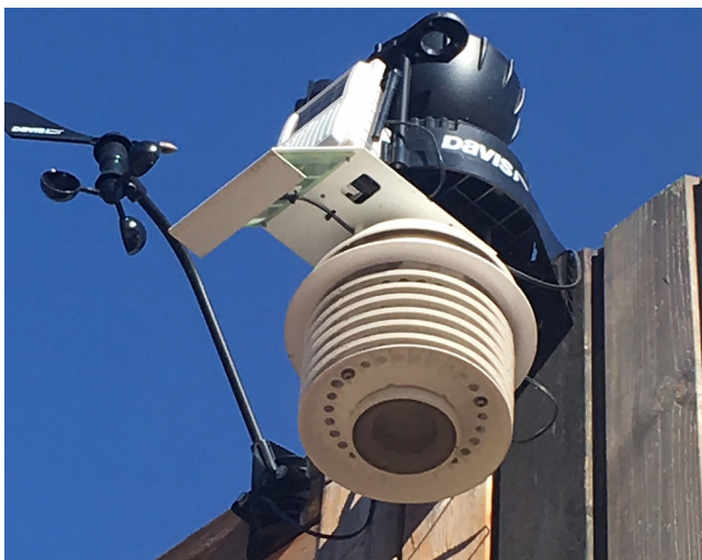
Figura 8. Estación meteorológica en fachada Sur.
