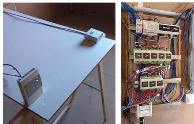
Figura 7. Sensores en interior de celdas y Panel de monitorización.
