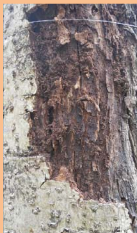
Figura 5. Lesão grave, ocasionada por insetos
