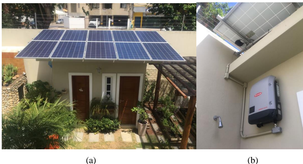
Figura 03a e 03b. Vista dos 10 PFV's policristalinos de 240W_P que compõe o sistema de ESFV por meio de GD com potência de 2,1 kW_P da residência em estudo. Fonte: próprios autores.
