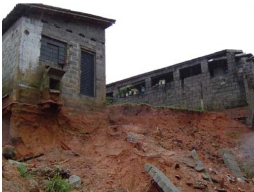
Foto 2: Detalhe da ruptura de um aterro nos fundos de uma moradia no município de Tapiraí (SP). Notar como não há danos à estrutura da moradia. Fonte: Arquivo IPT.
