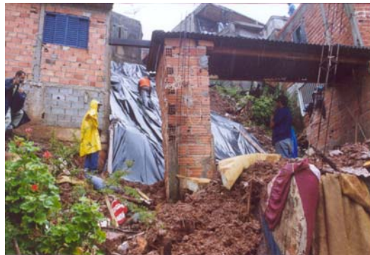
Foto 3: Moradia localizada em assentamento precário em Taboão da Serra (SP), completamente destruída por uma ruptura em corte. Fonte: Arquivo IPT.
