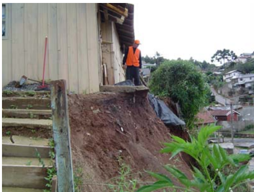
Foto 1: Detalhe de uma ruptura em aterro ocorrida no município de Campos do Jordão (SP). Notar como a estrutura da moradia não foi atingida. Fonte: Arquivo IPT.
