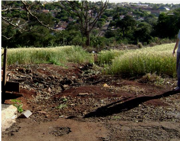
Foto 03. Setor de forte fragilidade. Início de processos erosivos gerados pelo escoamento superficial, localizados no final da Rua Graça, Bairro Marechal. Fonte: acervo do autor (agosto de 2011).
