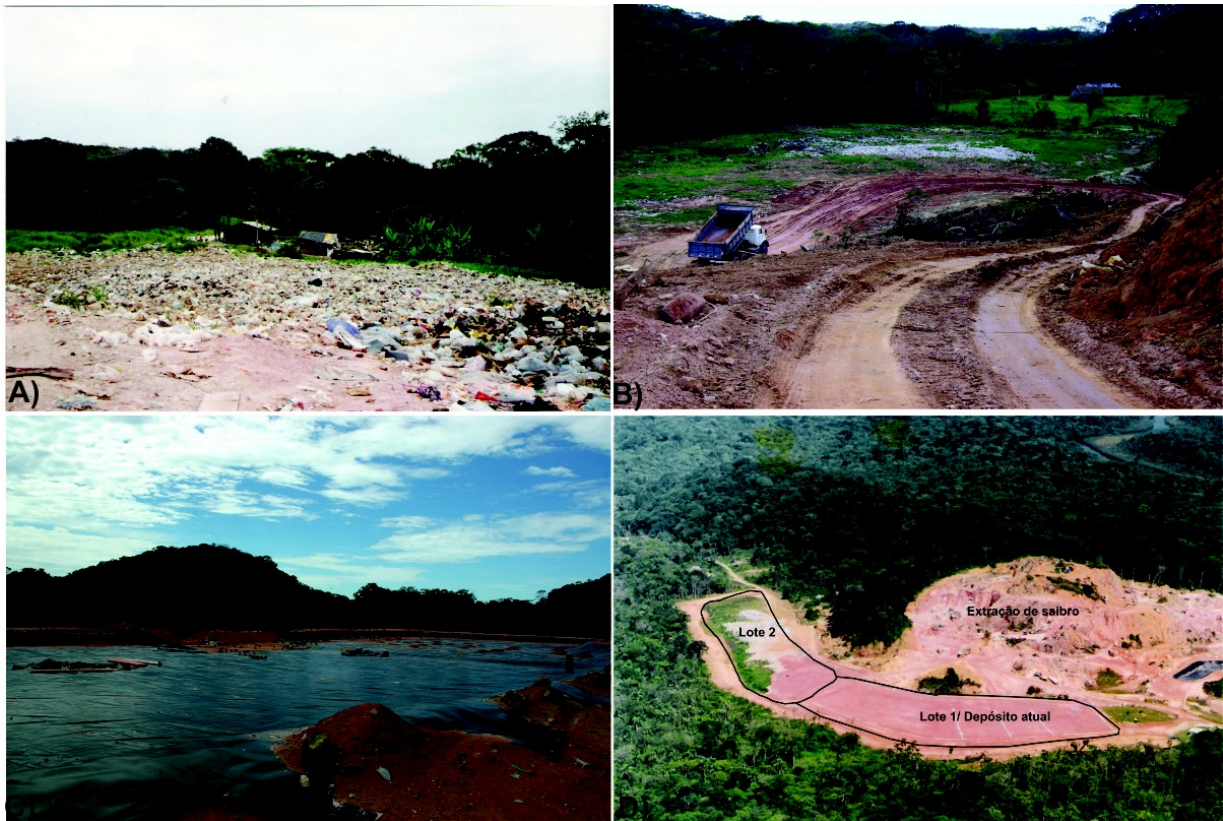
Figura 2 - Fotos do aterro sanitário de Guaratuba: A) Antigo lixão; B) Obra de readequação; C) Manta geotêxtil do aterro futuro (lote2); D) Visão panorâmica do aterro sanitário em fase de construção (fotos cedidas pelo gerente Élcio da Veiga).
