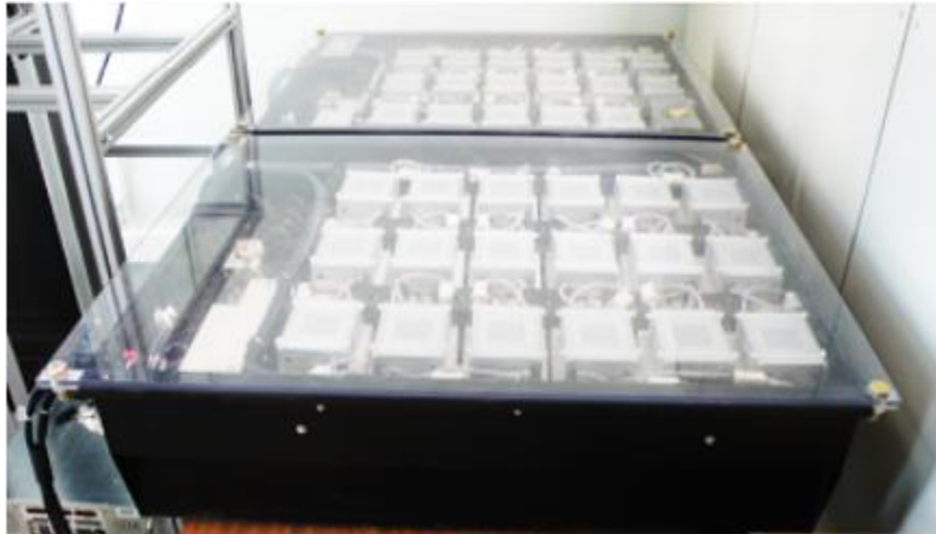
Figura 7. Supercondensadores SAFT 32F 270V.
