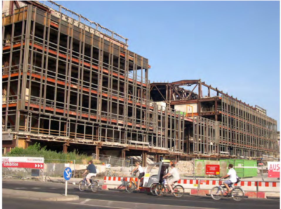
Fig. 14. Comienzo del proceso de demolición del Palast der Republik en 2006 (fotografía de la autora).
