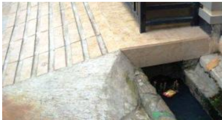
Gambar 2. Kondisi Saluran Air
