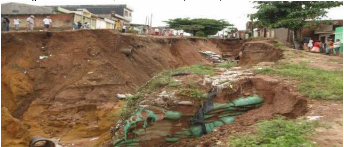
Figura 3 - Rua dos Emboabas no bairro da Liberdade, Garanhuns – PE, gravemente erodida, fruto da falta de políticas públicas eficazes.
