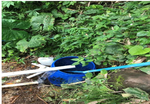
Gambar 3.2. Foto instalasi pemipaan dan pompa yang lama
