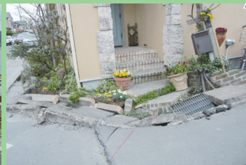
2011年東日本大震災・浦安液状化被害
