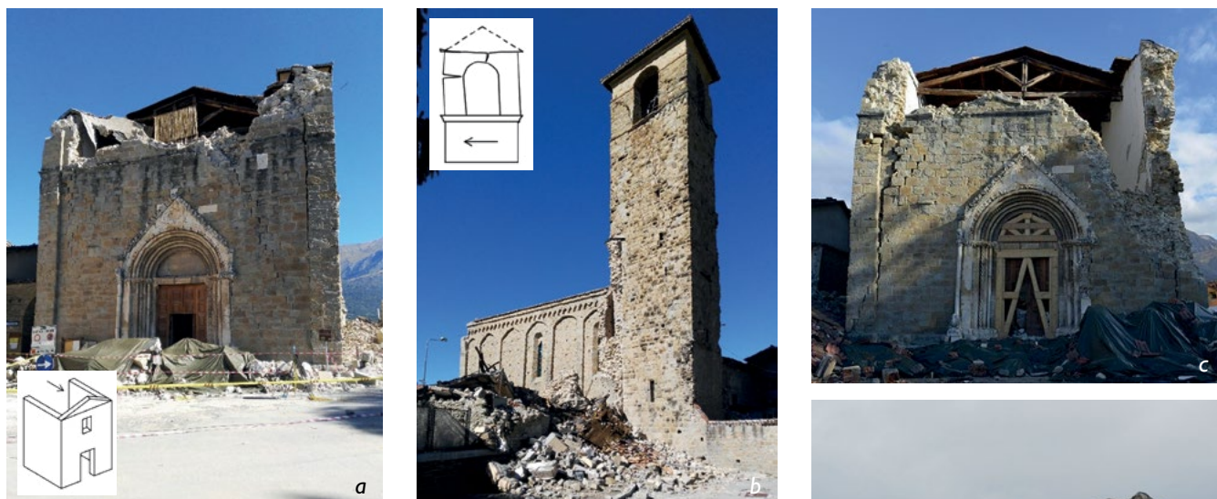
Figura 5. Evoluzione dei crolli durante la sequenza sismica. (a) La chiesa di Sant'Agostino dopo la prima scossa sismica del 24 agosto 2016. (b) Il crollo dell'arco "Carbonara" e il danno sulle strutture murarie del campanile (le immagini riportano anche gli schemi dei meccanismi di danno in relazione agli elementi architettonici della chiesa, secondo la Direttiva del Presidente del Consiglio dei Ministri 9 febbraio 2011, Valutazione e riduzione del rischio sismico del patrimonio culturale con riferimento alle Norme tecniche per le costruzioni di cui al D.M. 14/01/2011. Pubblicata nella G.U. n. 47 del 26/02/2011, suppl. ord. n. 54, 2011) (c) Progressivo collasso della facciata dopo il sisma del 30 ottobre 2016. (d) Ultimo collasso dopo il terremoto del 18 gennaio 2017.
