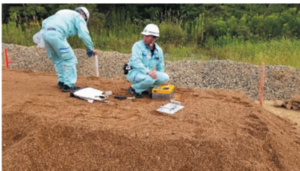
写真 13 RI および砂置換の状況 Photo 13 Investigation status of RI and sand replacement method.
