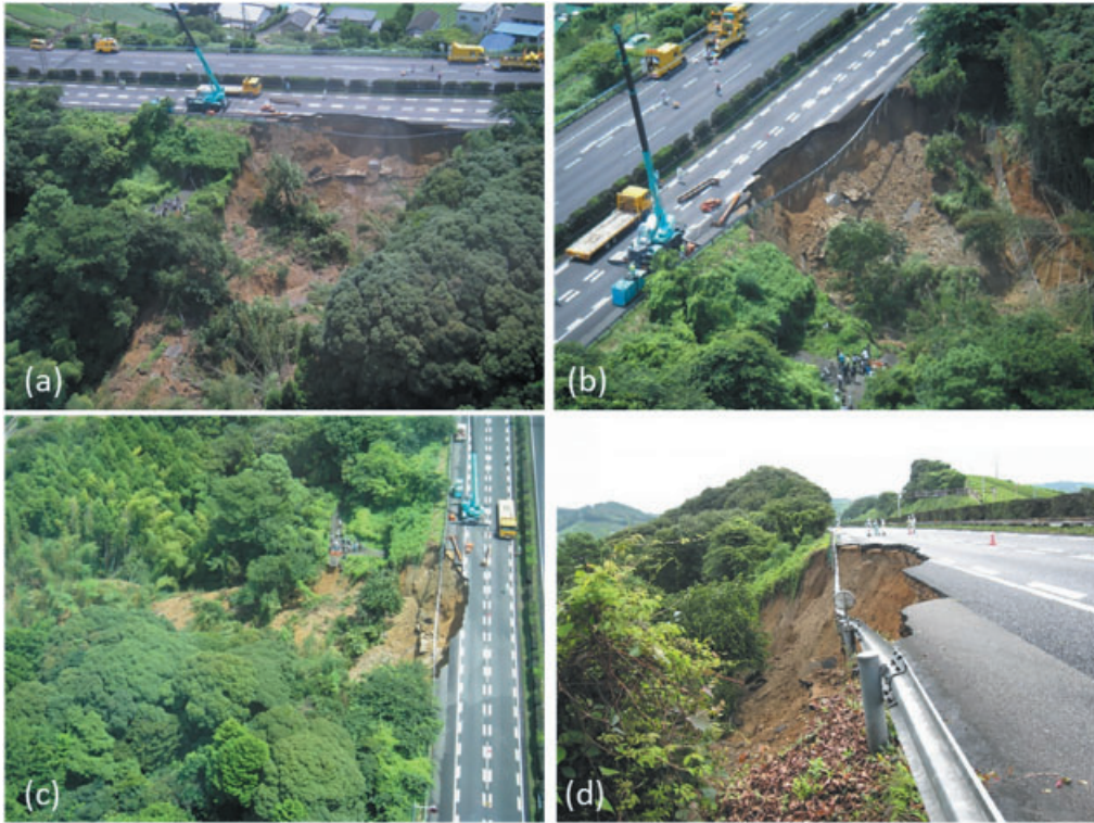
写真 2 損傷状況 9) Photo 2 Damage situations.
