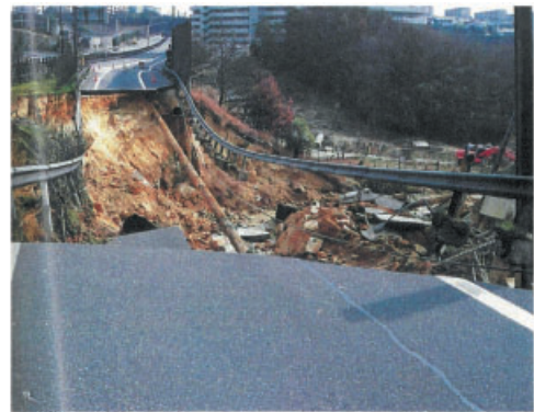
写真 3 大蔵谷 IC 被害状況 12) Photo 3 Damage situation at Okura-dani IC.
