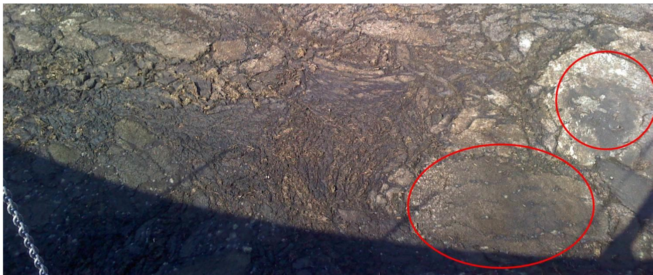
Abbildung 14: Beispiele für "geschlossene Schwimmschicht" rot markiert, Rest der Fläche entspricht der Kategorie "undicht! (Risse vorhanden)", Foto: Lippmann
