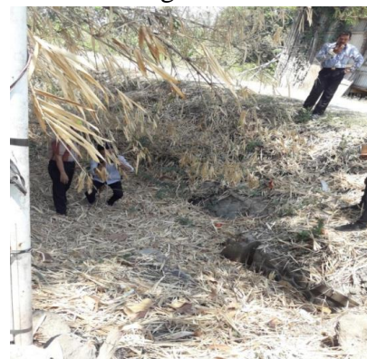
Gambar 3. Dinding saluran yang mengalami kerusakan
