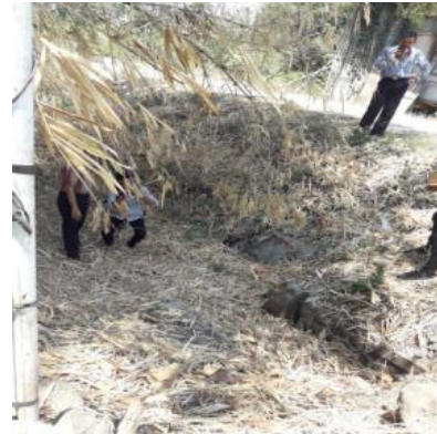
Gambar 2. Proses inventarisasi kerusakan pada saluran irigasi
