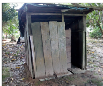
Figura 1 - Fossa seca fechada na comunidade de São Lázaro.
