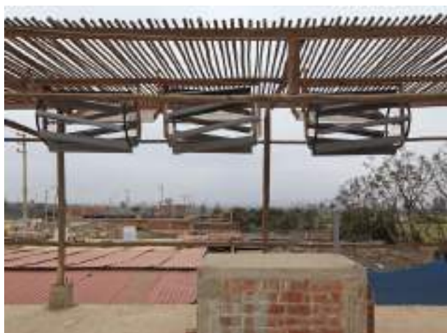
Figura 19 Turbinas eólicas instaladas en la azotea de la vivienda, colgadas de la estructura de madera. Participación de alumnos de la Universidad de Lima. Fotografía: Juan Solano
