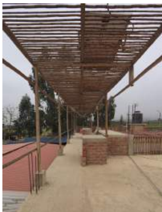
Figura 16 Estructura de madera en la cual se instalaron las turbinas eólicas Fotografía: Juan Solano
