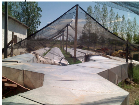
Figura 1: Vista frontal de Colectores solares y Pantalón realizado en Chapa galvanizada, y con la protección antigranizo de los colectores
