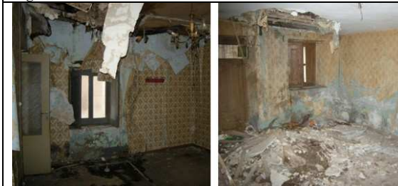
Figura 11: Fotos relevamiento del estado edilicio actual
