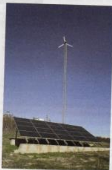
Painéis solares e turbina eólica: fontes alternativas de energia (Centro de Estudos Regenerativos, da Universidade Estadual Politécnica da Califórnia, em Pomona – EUA).
