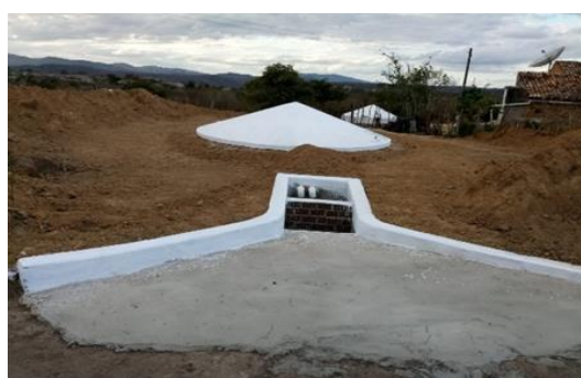
Figura 21 – Cisternas de enxurrada
