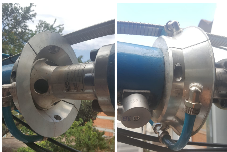
Figura A.10: Injetor de ar instalado na bomba BCS
