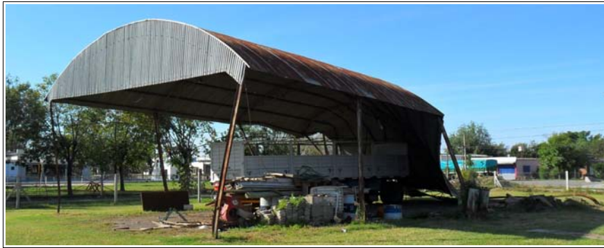
Figura 2: Cubierta aislada colapsada, tormenta 05-4-2012.
