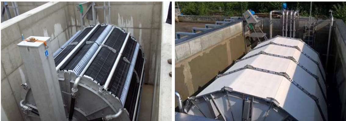
Abb. 6-3 Installierte Membranmodule: VRM 30/544 (links) und VRM 50/48 (rechts)
