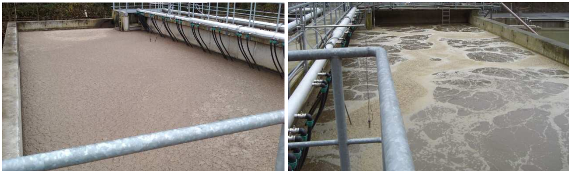
Abb. 5-55 Belebungsstufe vor (links: 10.11.2011) und nach (rechts: 12.03.2012) Optimierungsmaßnahmen zur Verbesserung der Belebtschlammqualität
