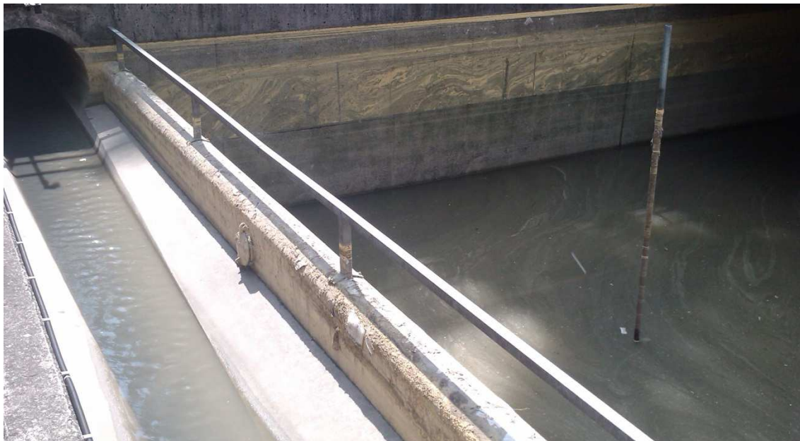
Abb. 5-23: RÜB im Hauptkanal zur Kläranlage (Aufnahme vom 05.05.2011)
