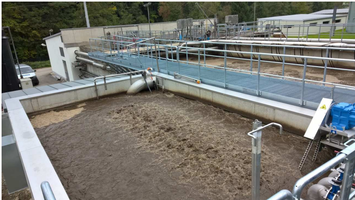
Abb. 6-2 Erweiterte Filtrationskammer der VRM 4 in Betrieb
