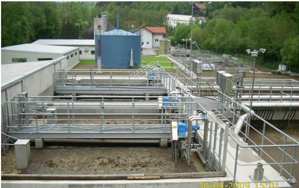
Abb. 3-2: Kläranlage Hutthurm mit Blick auf die Filtrationskammern (links) und die Belebungsbecken (rechts)
